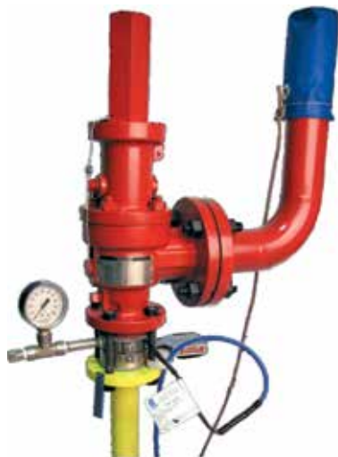
Установка мембраны совместно с предохранительным клапаном
